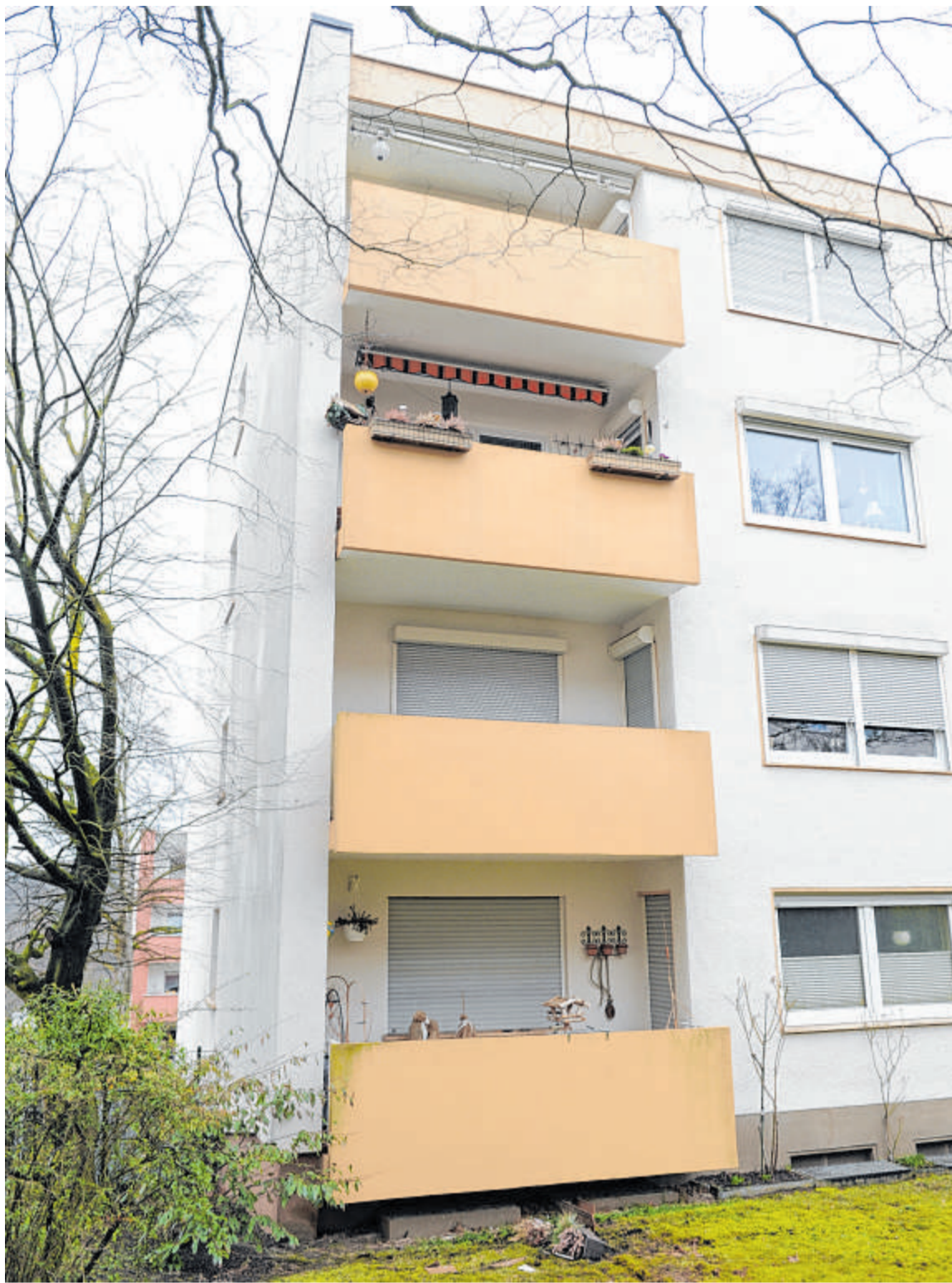
Am obersten dieser vier Balkone hatte das Drama seinen Ausgangspunkt. Am Balkon darunter fehlt der mittlere Blumenkasten, er wurde offenbar mitgerissen.
